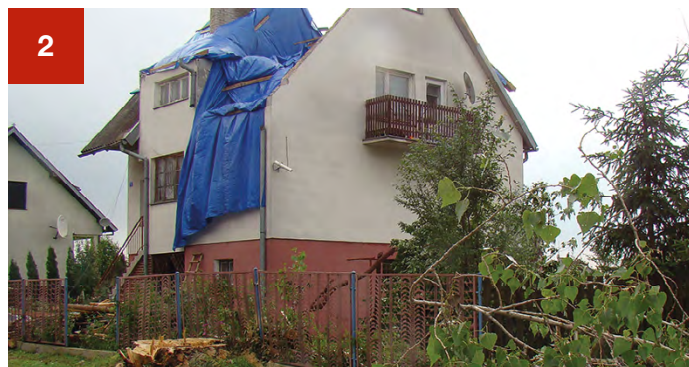
Zerwany dach budynku mieszkalnego
